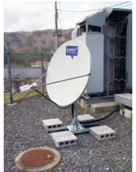
既設局エントランス回線利用 (石巻市 雄勝地区)
