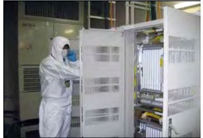
【4月13日】 基地局伝送路の切替 (富岡町内の通信ビル)
