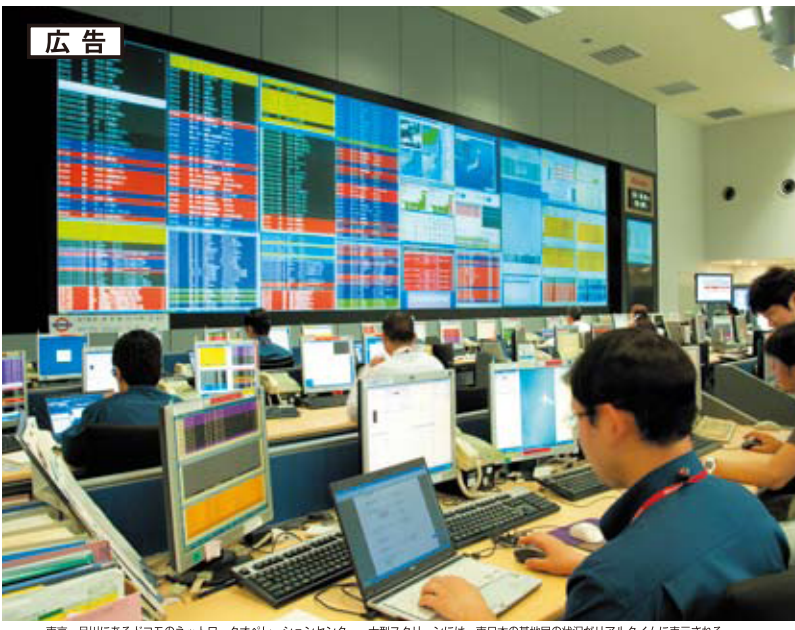
東京・品川にあるドコモのネットワークオペレーションセンター。大型スクリーンには、東日本の基地局の状況がリアルタイムに表示される
