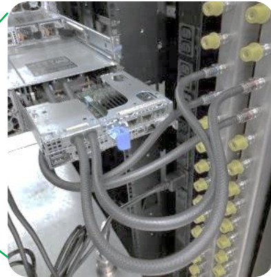
液冷サーバー 対応設備
