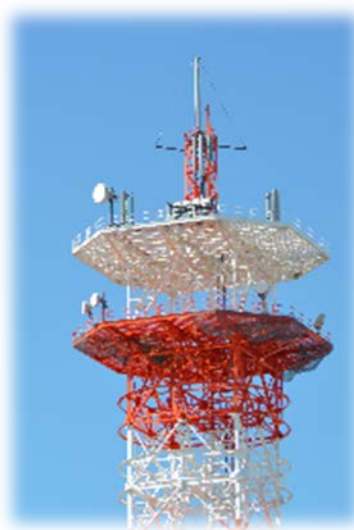
災害対策 (大／中ゾーン基地局など)
