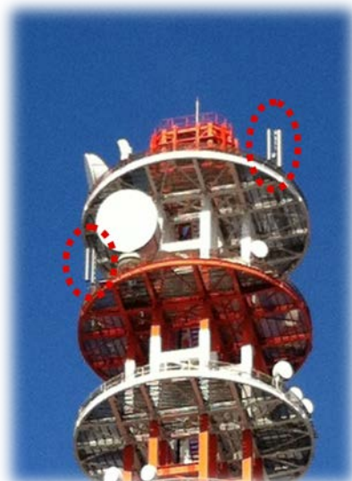
災害対策 (大／中ゾーン基地局など)
