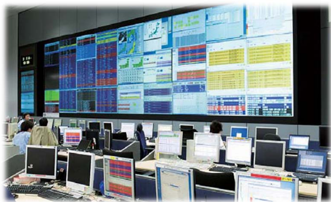
ネットワーク設備 常時監視
