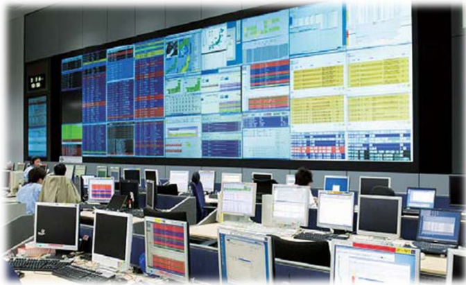
ネットワーク設備 常時監視
