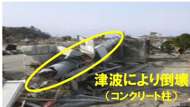
①基地局設備(宮城県 松島野蒜)
