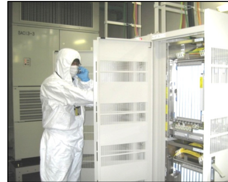
基地局伝送路の切替 (富岡町内の通信ビル)
