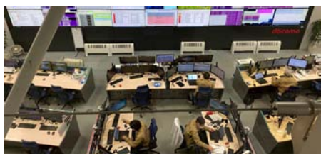
24時間365日休むことなく設備を監視しているネットワークオペレーションセンター
