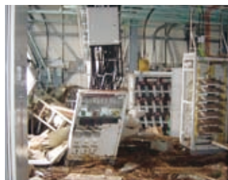
通信設備（岩手県野田村設置）
