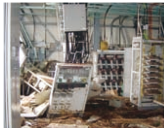
通信設備（岩手県野田村設置）
