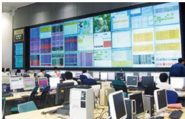
基地局や回線を24時間365日監視、制御を行っているドコモのネットワークオペレーションセンター
