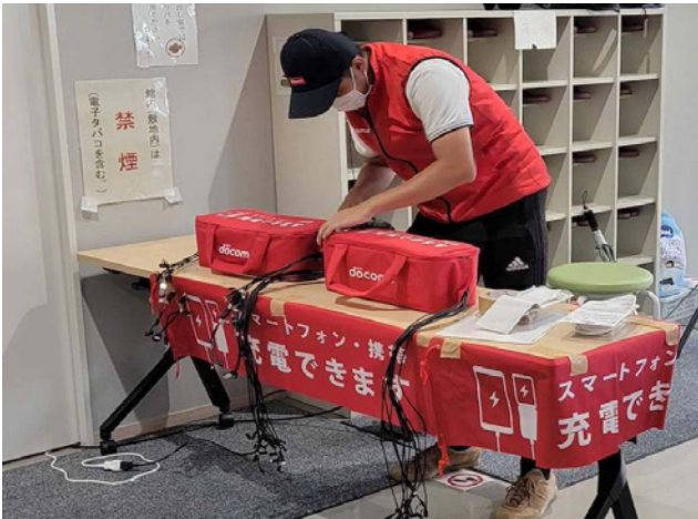
マルチチャージャーの設置
