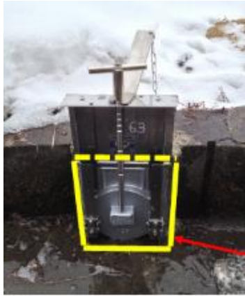
<自動給水栓装置「田門」>
