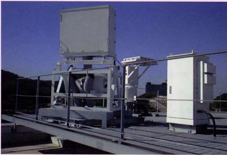
(a) アンテナ部
