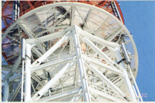
図3 基地局アンテナ Figure 3 Base Station Antenna
