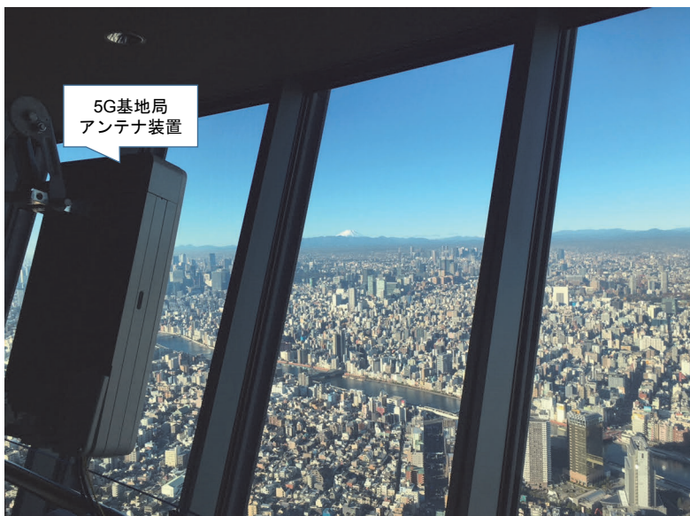
写真1(a) 5G基地局装置（東京スカイツリー天望デッキ）
