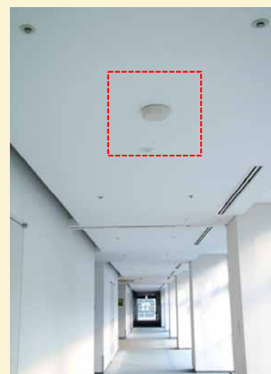
写真2 屋内用アンテナ通路への設置例
