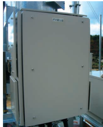
写真1 屋外ブースタ装置の外観
