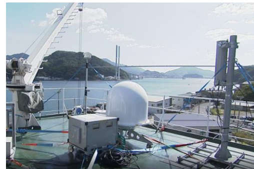
船上基地局設営訓練完了
