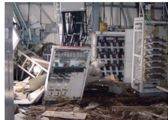
被災した通信ビル内の伝送設備 (岩手県野田村)
