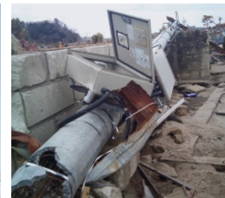
津波により倒壊した基地局設備 (宮城県東松島市)
