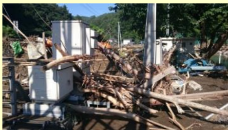
基地局装置の浸水、瓦礫散乱
