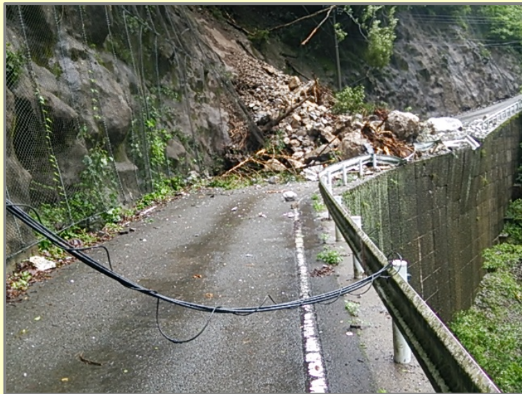
伝送路切断箇所(土砂崩れ)
