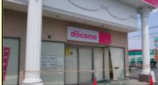
(DS嘉島店) 建物に多くのヒビ割れが発生したため、修繕工事を実施した後、2016.4.29に営業再開。
