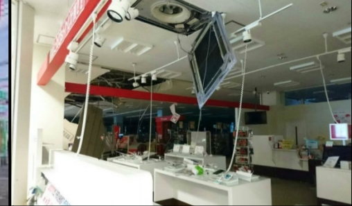
(DSイオンモール宇城店) 天井落下等の損壊とスプリンクラー作動による水濡れのためモールが一部休館となり、当面休業。2016.6.30に営業再開。
